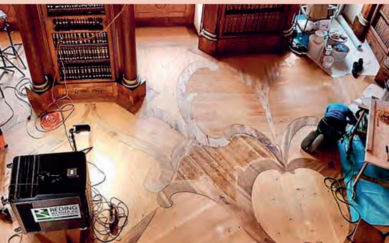
Etwas Technik muss sein, um etwaige Lösungsmitteldämpfe da abzusaugen, wo sie entstehen
